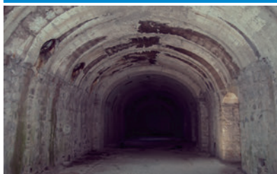
電力、農水（水路トンネル）
